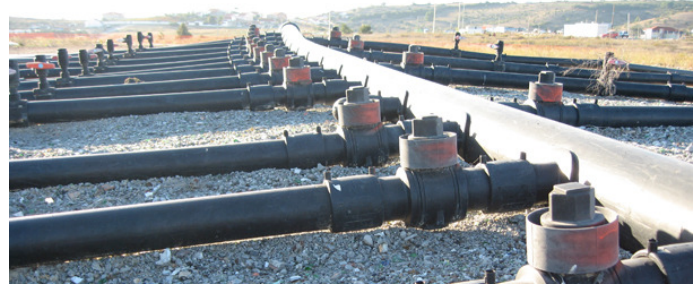
Drenagem de Metano em aterro sanitário
